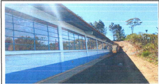
Foto 1: Se observa en el area de los ventanales al aire libre por falta de balcones.
