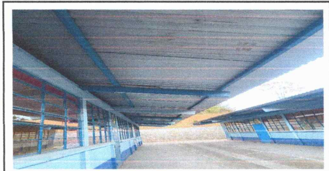
Foto 3: Se observa la falta de seguridad en los focos que alumbran el area del pasio
