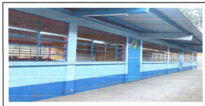
Foto 5: Se observa la falta de balcones en los ventanales.
