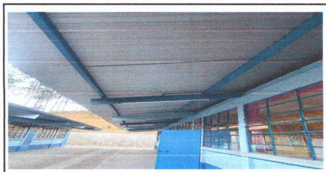
Foto 6: Se observa la falta de focos.
