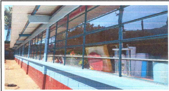
Foto 2: Se observa en el area de ventanería la falta de seguridad.
