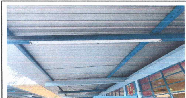
Foto 4: Se observa focos dañados por la falta de seguridad en ellos.
